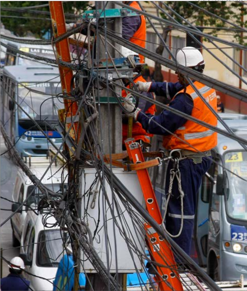
EXCESO DE CABLES en la vía pública es una preocupación para los penquistas.
