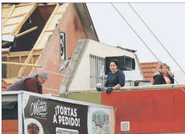
TEMOR CAUSÓ EN Brisas del Sol la destrucción de viviendas. Techumbres desaparecieron con el paso del tornado.
