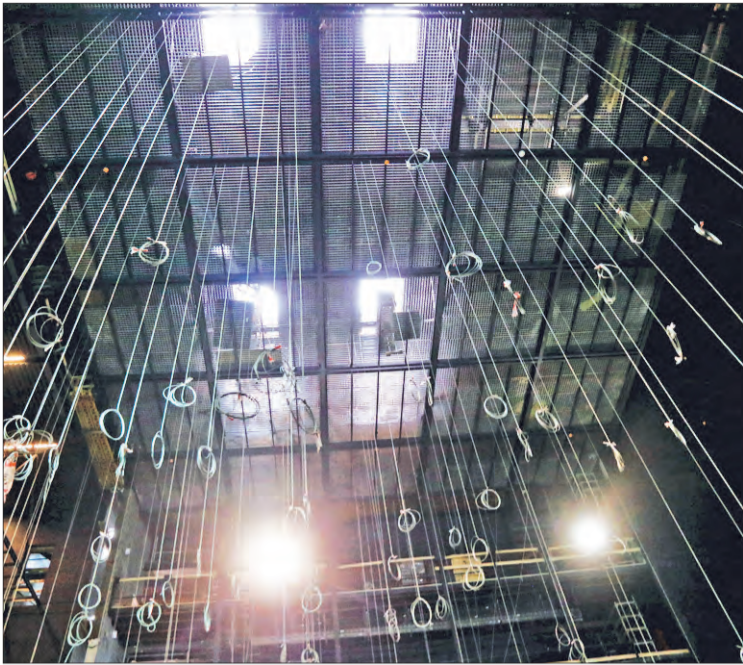
LOS CABLES DE LA escenotecnia de la sala principal están todos listos.
