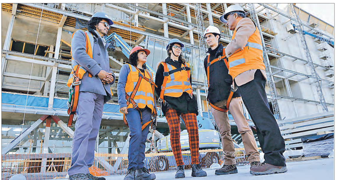
AUTORIDADES DEL MOP, Consejo de la Cultura y de la Corporación Cultural del Teatro Regional han unido fuerzas para sacar adelante este anhelado proyecto cuya construcción culminaría en diciembre.
