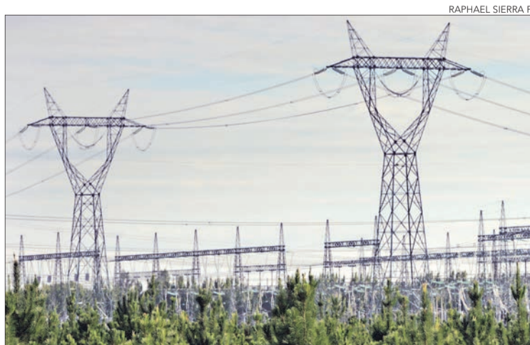
LA TECNOLOGÍA identifica puntos críticos en tendido eléctrico.
